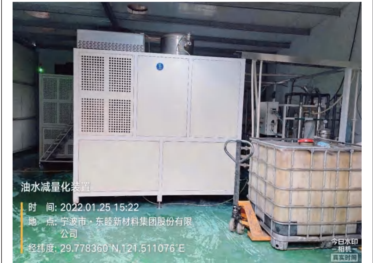
图 13 油水混合物浓缩减量装置
