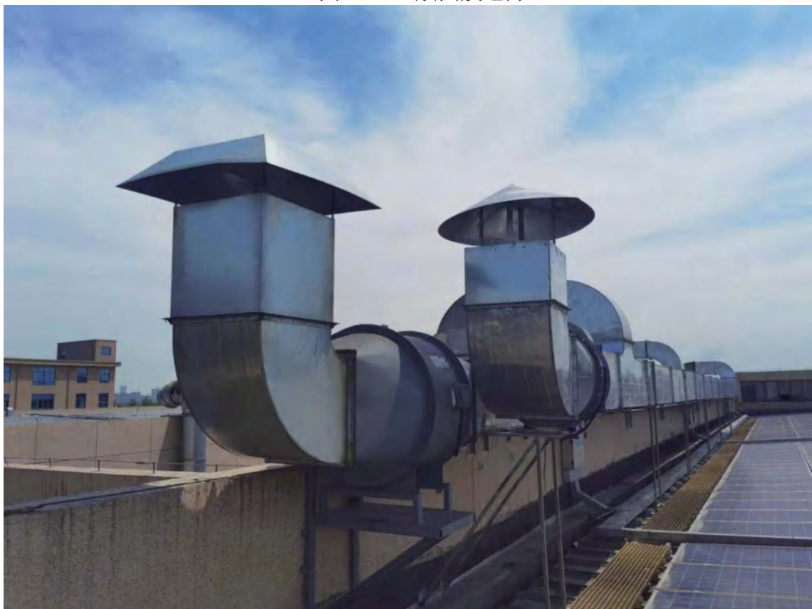
图 20 清洗车间废气排放口（右）
